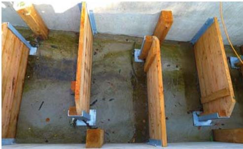
Abb. 3: Der sogenannte „Vertical-Slot-Fischpass“ überwindet einen Höhenunterschied von 3,00 m und hat eine Gesamtlänge von 25 m.
