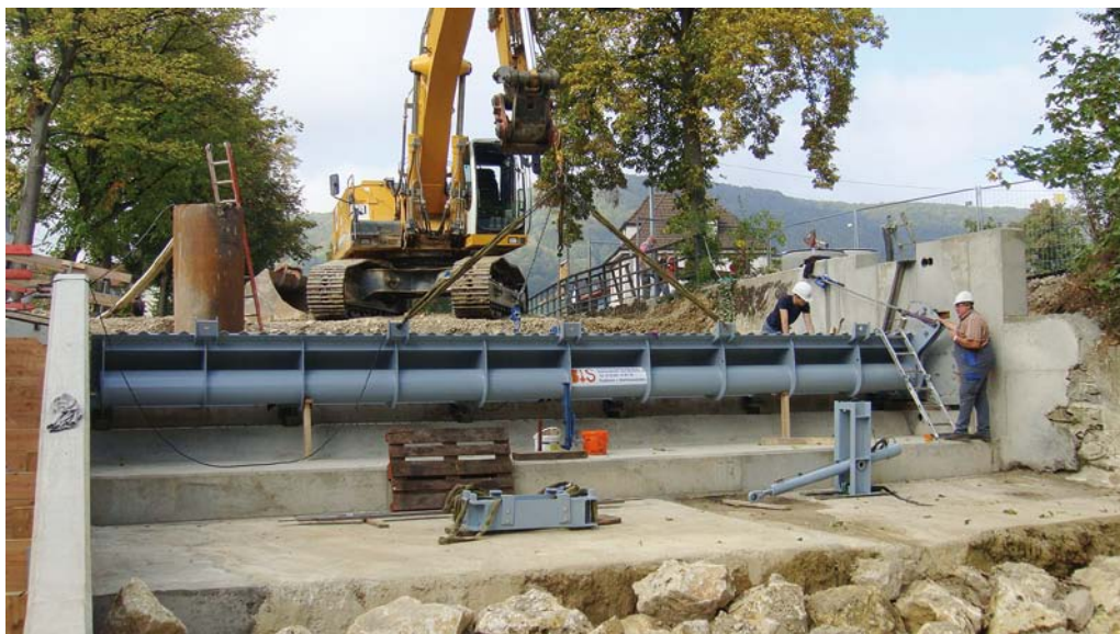
Abb. 2: Für die Montage der 10,30 m breiten und etwa vier Tonnen wiegenden Fischbauchklappe war schweres Gerät im Einsatz. Foto: Wald + Corbe Consulting GmbH
