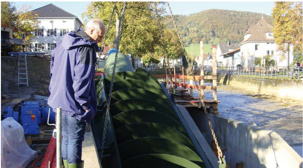
Abb. 1: Deggingen, im Jahr 2014: Beim Einbau der Wasserkraftschnecke war Millimeterarbeit gefragt. Sie hat einen Durchmesser von 2,30 m und eine Länge von 11 m. Foto: Wald + Corbe Consulting GmbH
